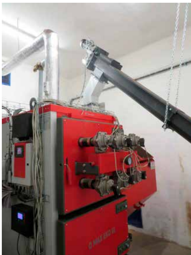
Nový automatický kotel ve školní kotelně
